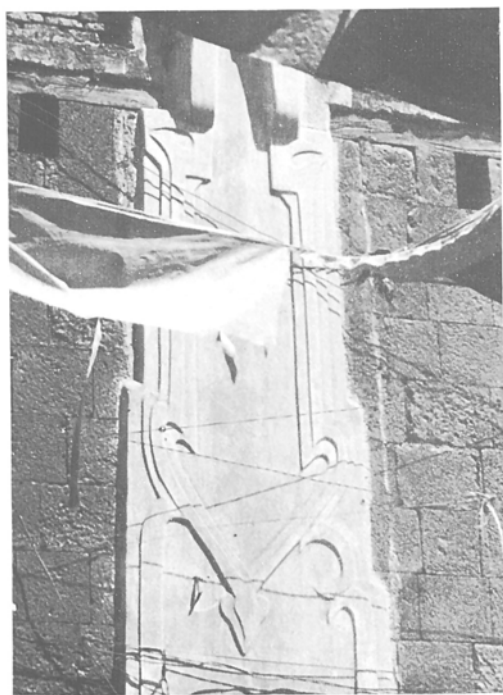
b) Sana'ā', un pannello in stucco per lo scolo delle acque piovane nel Samsarah Muḥammad b. al-Ḥasan b. al-Qāsim.
